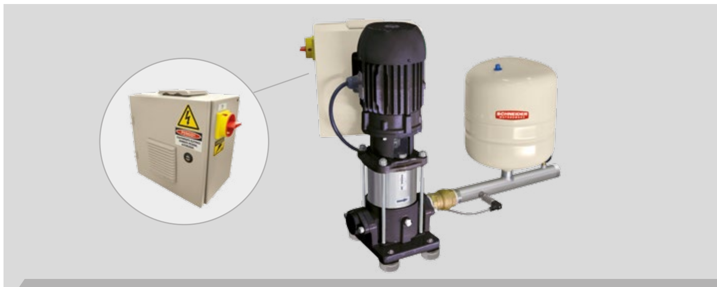
Sistema de pressurização acionado por inversor de frequência.
